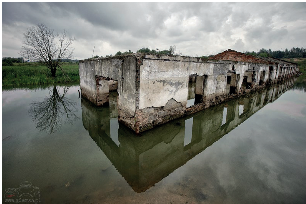
II. 1.5. Powódź od strony wód gruntowych. Źródło: http://powodz.gov.pl (dostęp: 21.05.2020)
