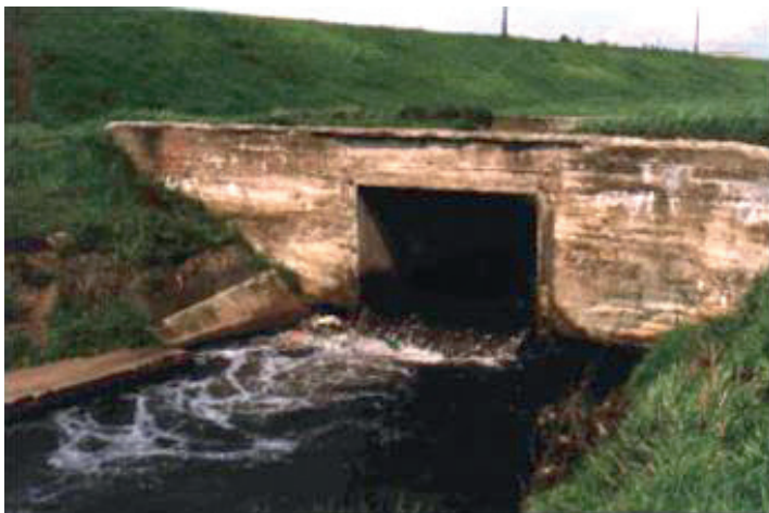
II. A.27. Przykłady konstrukcji mostowych o zbyt małym świetle poziomym i pionowym
