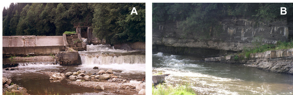
Fot. 3.7. Zniszczony korpus jazu w Poroninie (A) i jego mur boczny (B), zawieszony ok. 1,0-1,5 m nad dnem koryta (fot. J. Korpak)
