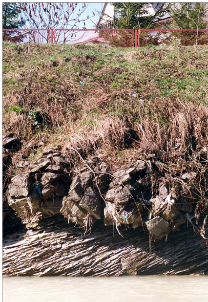
Fot. 3.4. Mszanka wcięta w litą skałę w odcinku uregulowanym za pomocą budowli podłużnych – zawieszona, niefunkcjonująca opaska siatkowo-kamienna (fot. J. Korpak)
