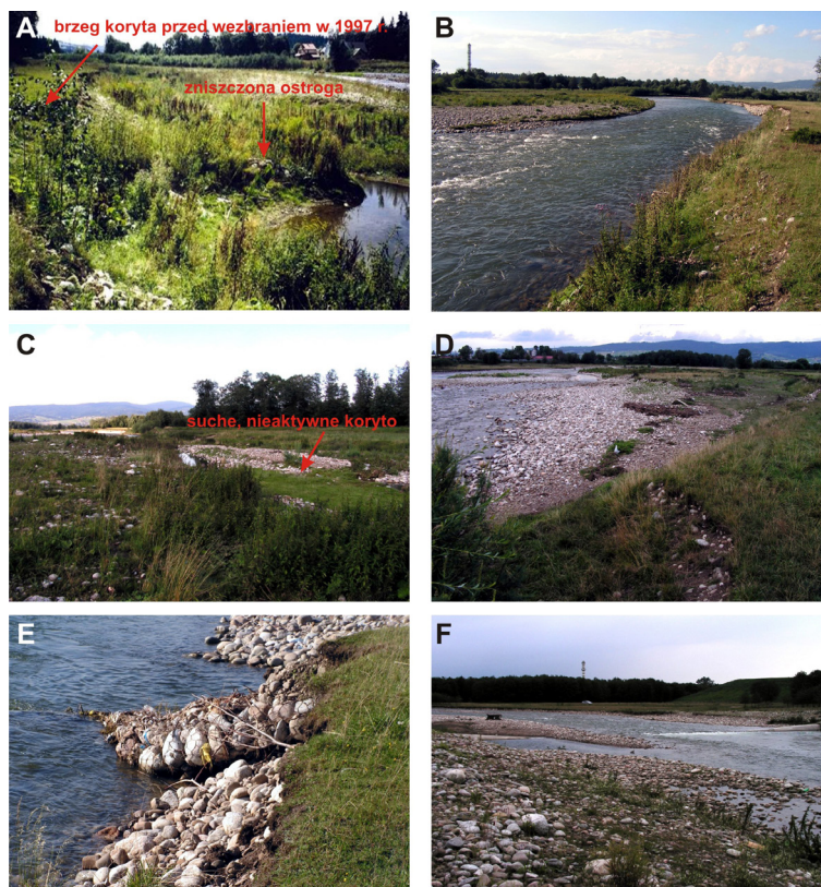
Fot. 3.14. Skutki wezbrań w latach 1997 i 2001 w wykształceniu koryta Białego Dunajca w Szaflarach: A) zniszczenie ostróg i poszerzenie koryta, B) podcięcia wysokich brzegów koryta, C) szerokie koryto wielkiej wody ze śladami nieaktywnych koryt i wielkimi, zarastającymi łąkami, D) koryto z kilkoma poziomami łąk, E) zniszczona, niefunkcjonująca ostroga w pogłębionym korycie, F) depozycja materiału i erozja brzegów oraz koron stopni w korycie z korekcją stopniową (fot. J. Korpak)
