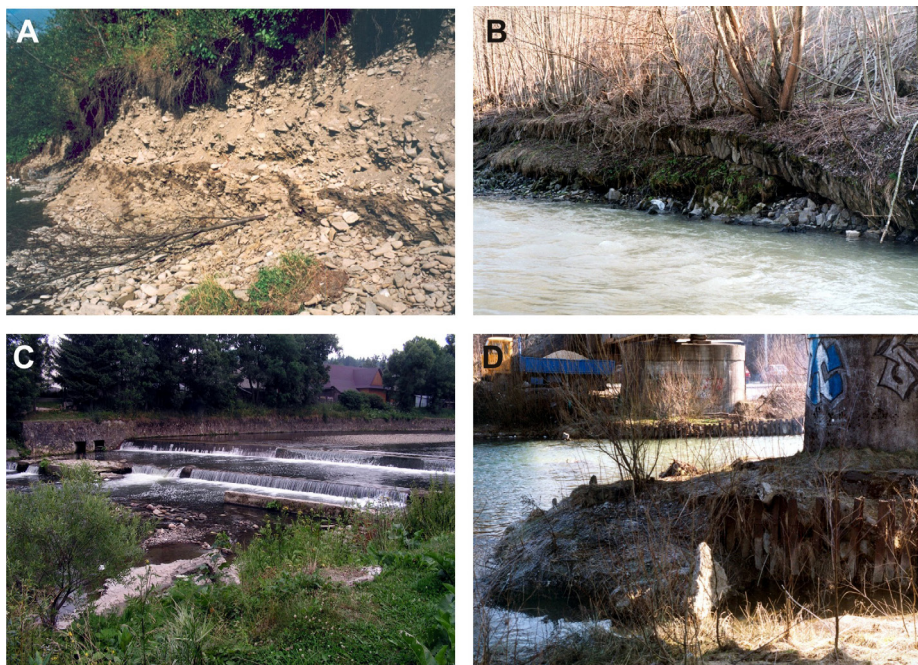
Fot. 3.15. Skutki pogłębienia koryt: A) wysokie, pionowe, niestabilne brzegi koryta, B) zniszczona, niespełniająca swych zadań podłużna zabudowa hydrotechniczna, C) zerodowane korony budowli poprzecznych, D) podcięte filary mostów (fot. J. Korpak)
