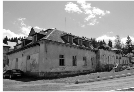
Il. 19. Dom Zdrowia Kolejarzy, widok od północnego zachodu, 2012 r. Fot. Jacek Czubiński
