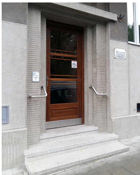
Il. 10. „Dom pod godłem górniczym”, Izidor Grynberg, 1937. Dolna część fasady została oczyszczona – uwidacznia się stopień zabrudzenia tynków, które nigdy w historii nie były poddawane czyszczeniu. Tynki te dobrze znoszą zabieg, a jego efekt należy uznać za spektakularny. Fot. M. Bogdanowska
