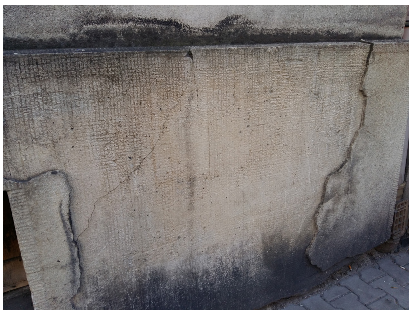
Il. 1. Rozległy ubytek warstwy wierzchniej tynku kamieniarskiego pokazuje obrzutkę z charakterystycznymi nasiekami, zwiększającymi przyczepność zaprawy. W przełomie widoczna jest grubość ostatecznej warstwy zaprawy. Fot. M. Bogdanowska
